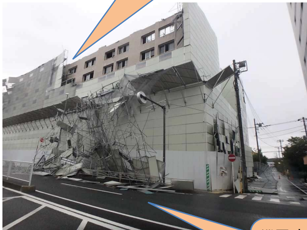
東側足場倒壊状況
