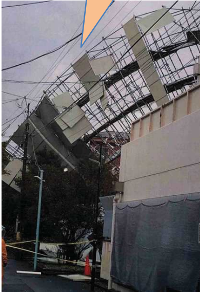
西側足場倒壊状況
